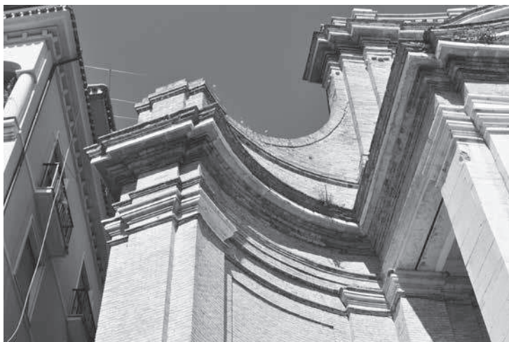
Fig. 6. Chiesa del Gesù. A poca distanza dal restauro la vegetazione invasiva è nuovamente presente all'estradosso delle volute e delle cornici. Nelle zone protette dal dilavamento si osserva già l'incipiente sviluppo delle croste nere.
