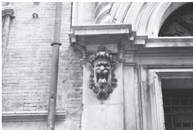
Fig. 7. Loggia dei Mercanti. Particolare della facciata. Sono evidenti il deposito superficiale e alcune croste nere in fase iniziale.
