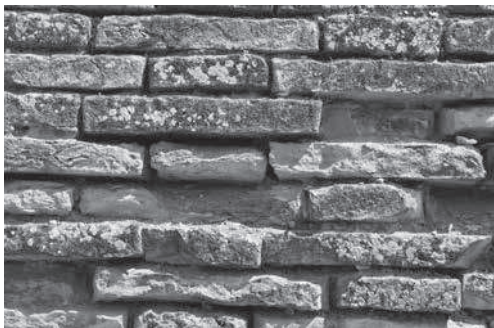
Fig. 5. Mura sangallesche. I mattoni del paramento murario appaiono in più punti polverizzati e mancanti.
